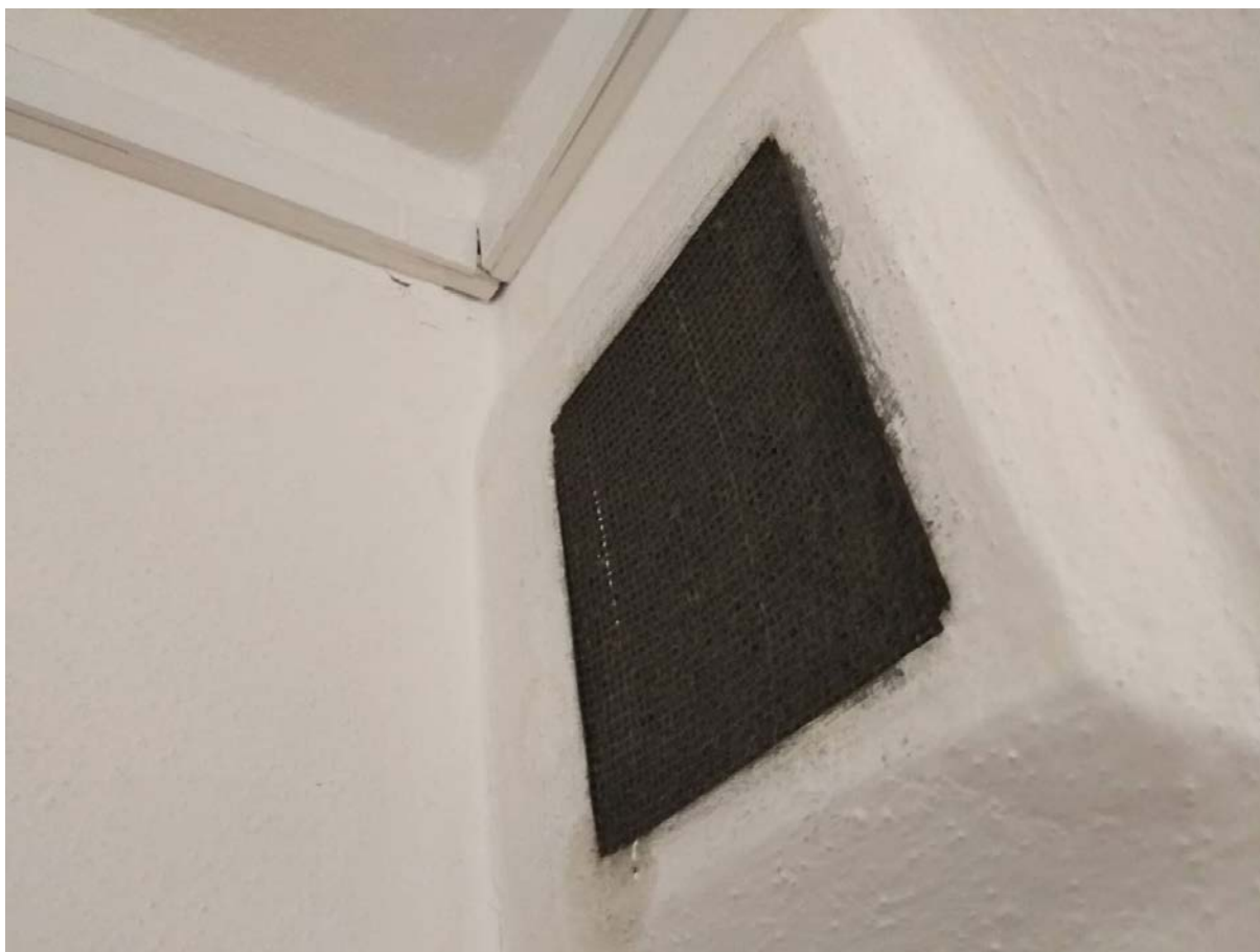
Obrázek 18 Vzduchotechnika kuchyněk J.L Fischera
